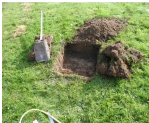
Der udgraves mindst 2 prøvehuller ned til det niveau, hvor faskinen skal ligge. Selve prøvehullet skal være min. 25 cm x 25 cm og mindst 30 cm dybt. Hullerne skal ligge mindst 5 m fra hinanden.
